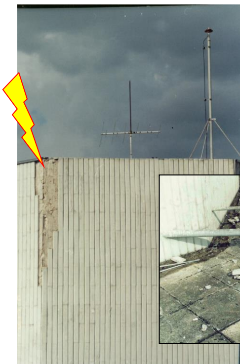
Foto 2 Dano mecânica na quina com desprendimento de material, apesar do captor radioativo existente (ausência de proteção normalizada) Local: Sto. Agostinho - Belo Horizonte - MG
