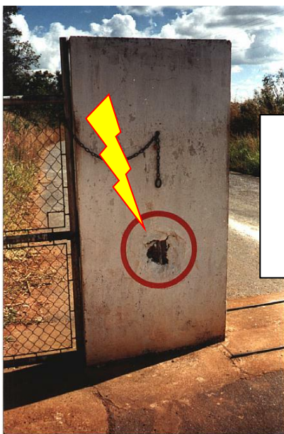
Foto 11 A descarga atingiu a parede a 1 metro do solo, desprezando o portão e corrente metálica próximos, comprovando o seu comportamento imprevisível. Juatuba - MG
