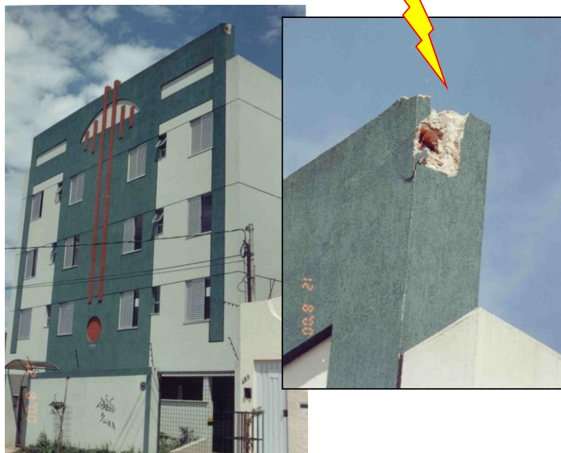
Foto 1 Dano mecânico comum em quinas de prédios (ausência de proteção normalizada) Local: Estoril - Belo Horizonte - MG
