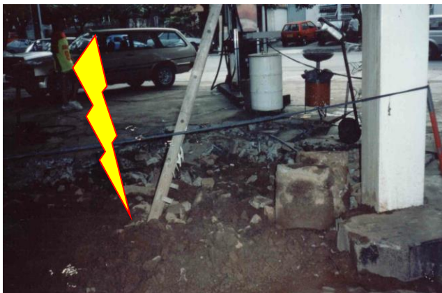
Foto 15 Posto de combustível danificado por uma descarga que caiu no prédio vizinho e provocou a explosão do tanque subterrâneo que por azar estava vazio, porém cheio de gases (área classificada) Local: Belo Horizonte - MG
