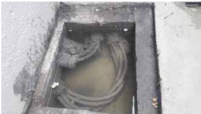
Exemplo de cabo imerso - isolamento inadequada.
