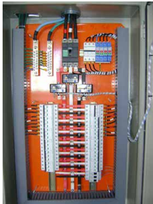
Exemplo de identificação de condutores por cor.
