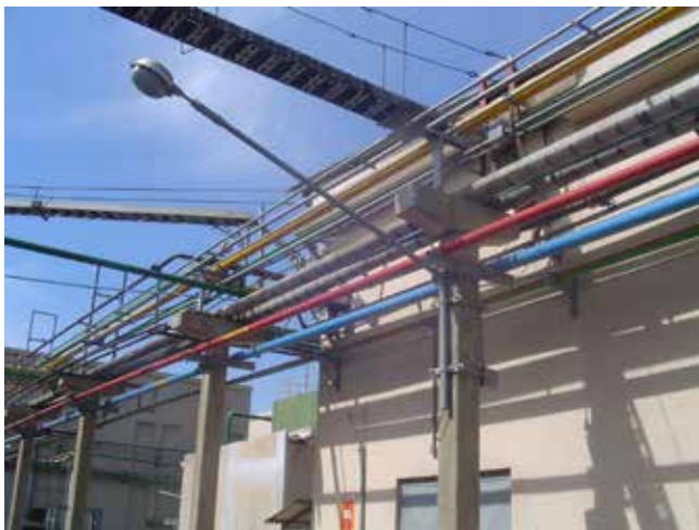
Exemplo de instalação de cabos ao tempo em pipe rack.
