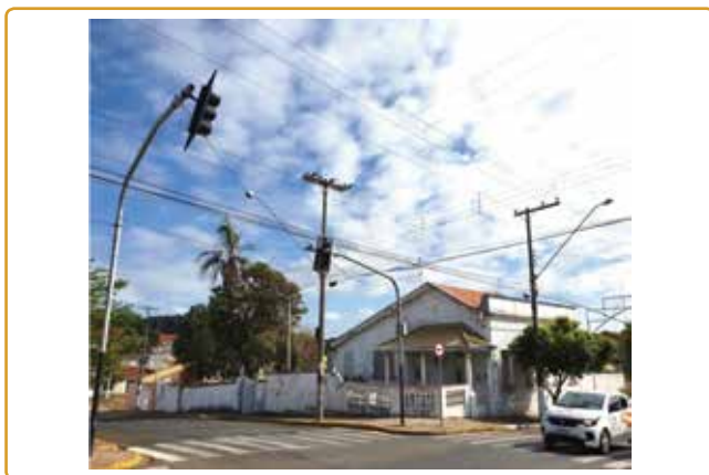
Figura 3 - Estrutura metálica típica de semáforos em via pública.
