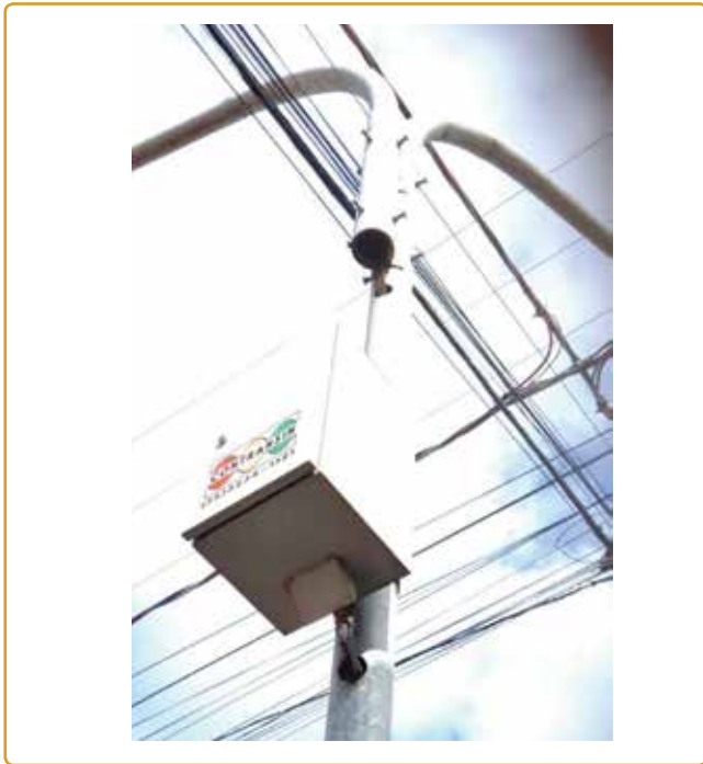
Figura 5 – Caixa de ligação na estrutura metálica do semáforo – sem proteção entre condutores de alimentação e borda metálica.
