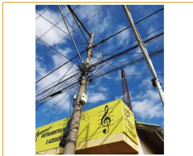
Figura 4 - Caixa de ligação dos condutores, alimentação dos semáforos instalados no poste.
